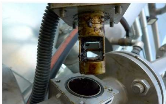
蒸気回収プロセスに設置された、アスファルトで汚れたセンサ
